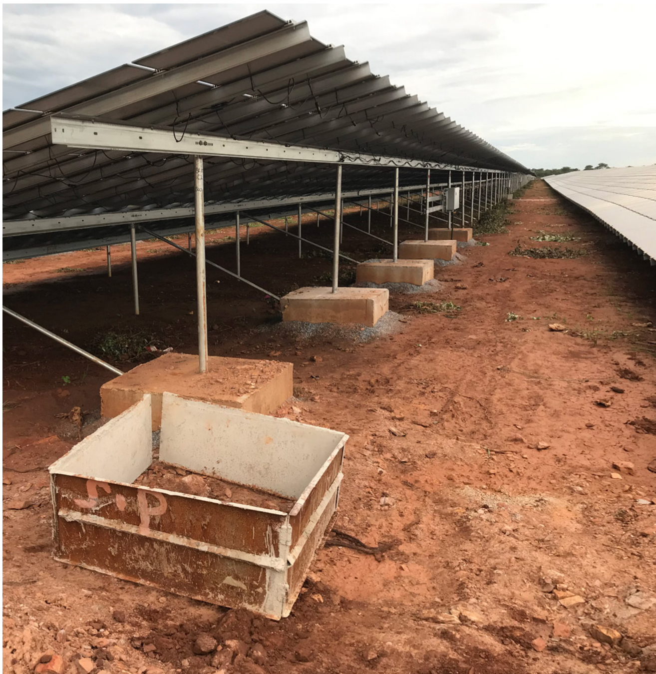
Eksempel på hvordan betong benyttes som ballast rundt pæler som står i jordsmonn med lav integritet. (Foto: Multiconsult)
