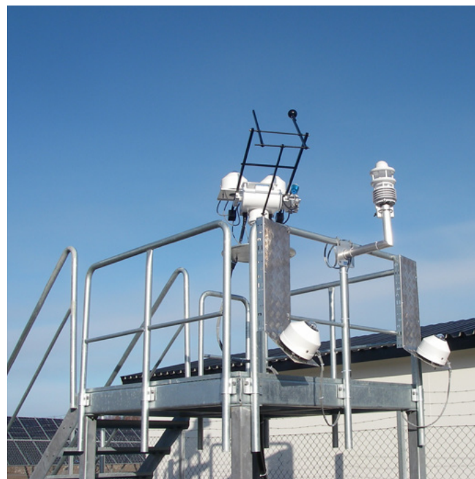
Eksempel på en målestasjon for temperatur og solinnstråling. Stasjonen på bildet er plassert i besøksanlegget til Glava Energy Center i Sverige. (Foto: Multiconsult)
