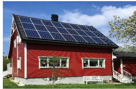
Solcellepaneler montert utenpå et hustak
