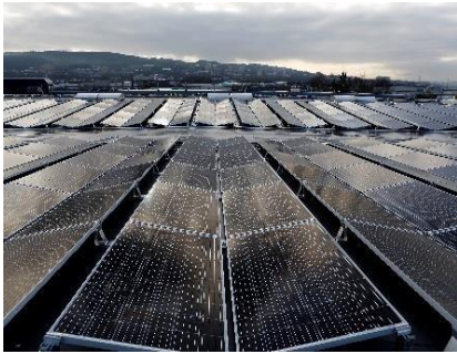
Solcellepaneler på industritak
