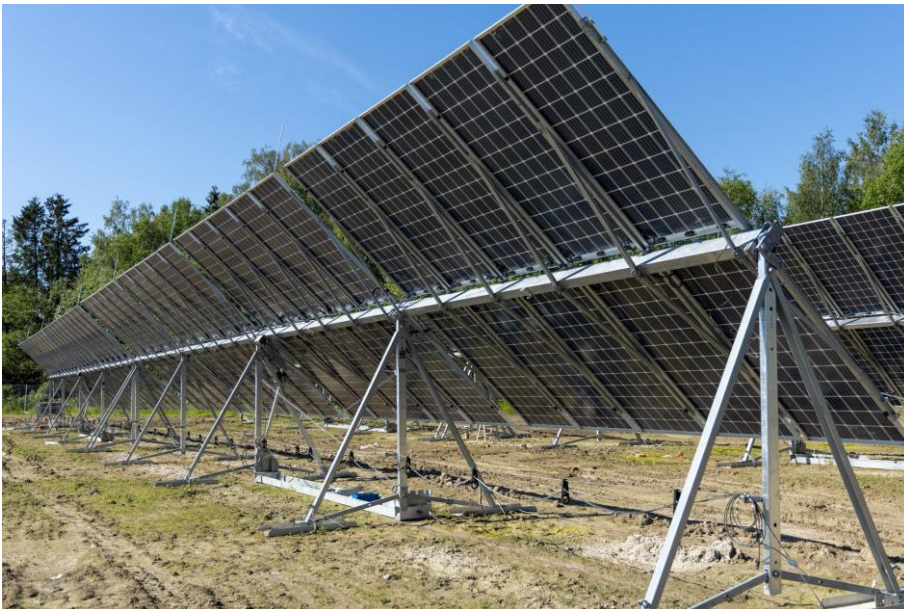
Figur 13: ROAF miljøpark i Lillestrøm kommune har solcelleanlegg med trackere og tosidige solcellepaneler. [12]
