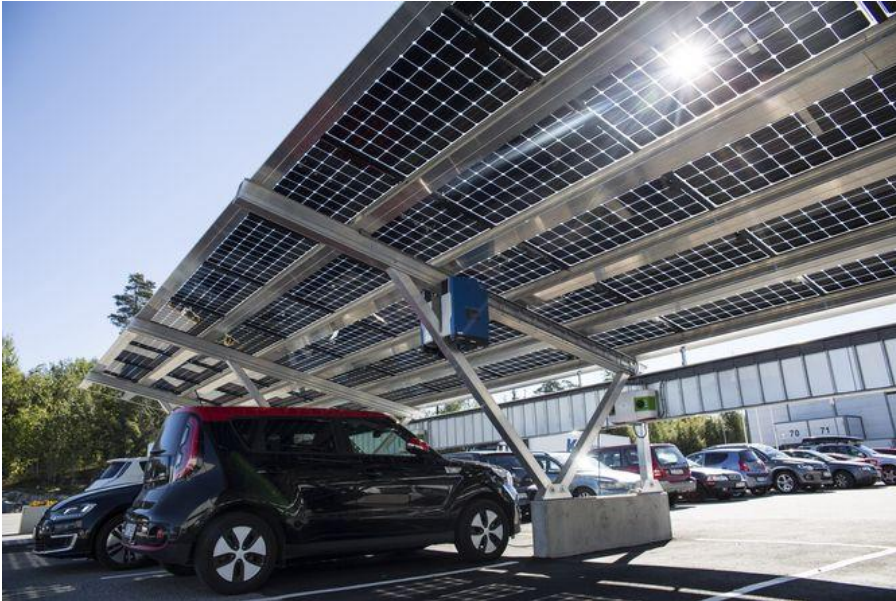
Figur 12: ASKO Bygg ØST i Vestby har tosidige solceller i carport tilkoblet elbilladere. [11]
